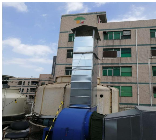
项目废气排放口
