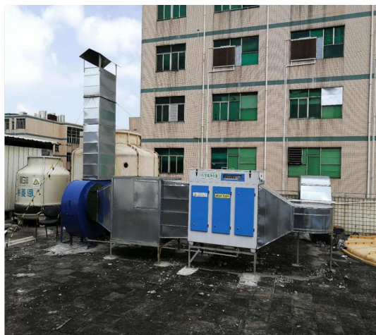
项目废气处理设施
