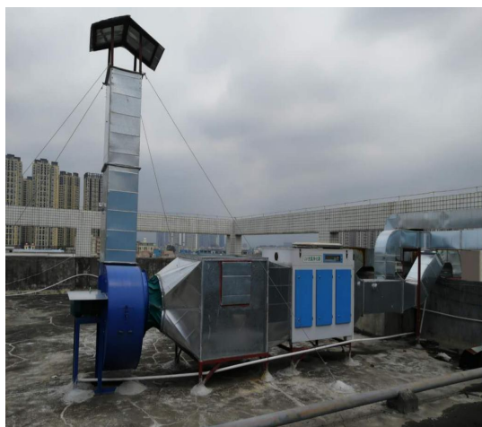
项目废气处理设施
