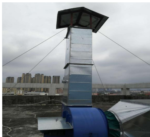
项目废气排放口
