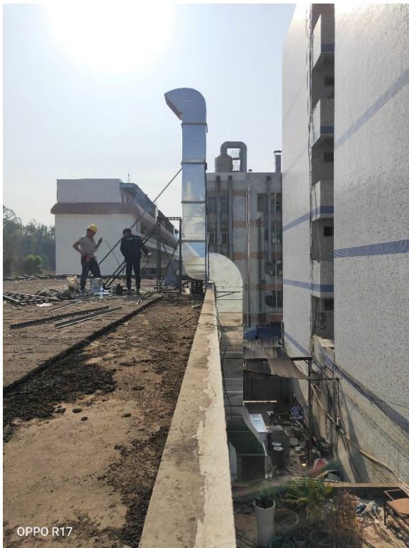
项目废气排放管道
