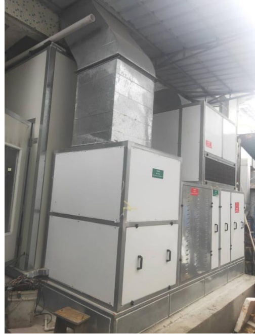
集气管道及废气处理设施
